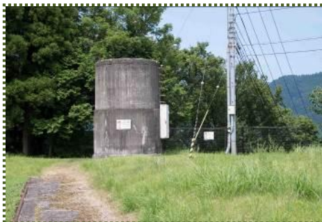
写真-7 サージタンク （口径 2.5m×高 6.0m）
