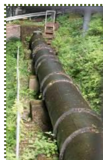
写真-8 水圧鉄管
