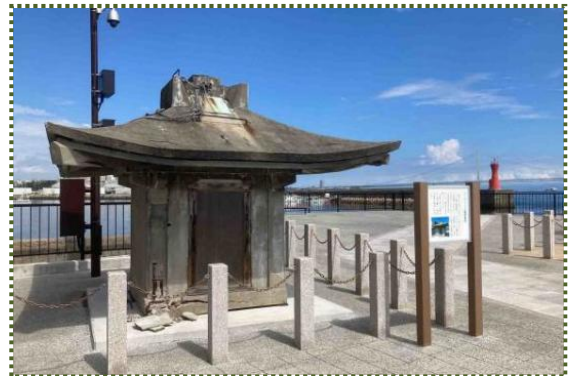
写真-5 コンクリート製の燈籠上部
