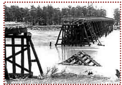
写真-7 落橋した初代神崎橋 (『大阪の橋〜神崎橋』から引用)
