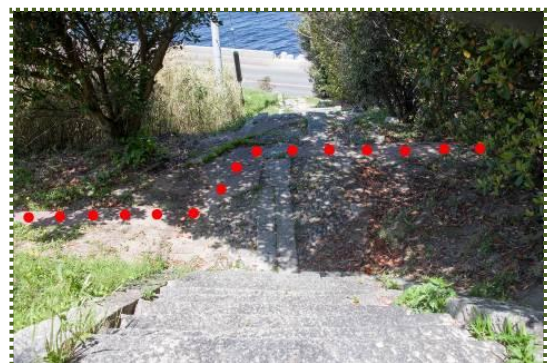
写真-7 江崎灯台に続く石段の右横ズレ箇所
