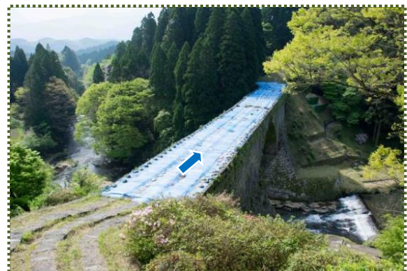
写真-7 熊本地震の影響でブルーシートが掛けられた通潤橋天端
