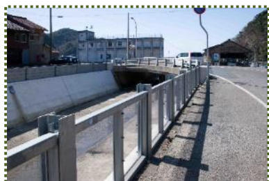
写真-3 港橋上流のバラベットの護岸（令和5年3月）
