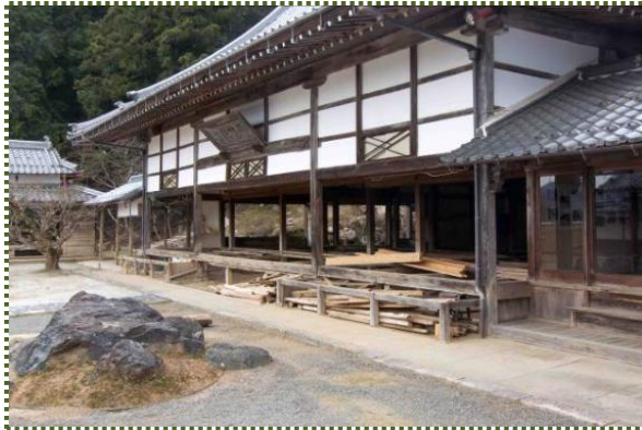
写真-6 石像寺本堂の被災状況（平成27年3月）
