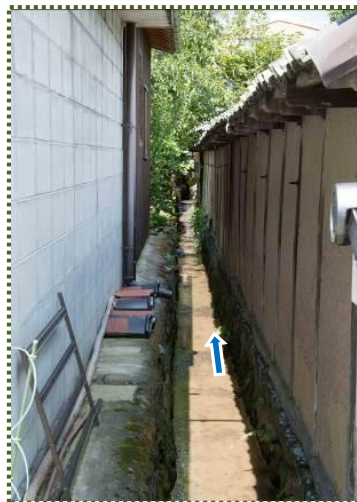
写真-6 背割下水路
