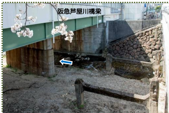
写真-4 阪神大水害で流失した旧桜橋の橋脚の一部
