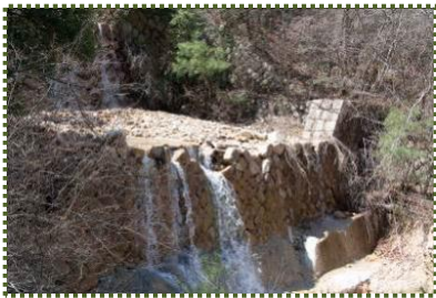
写真-12 崩れかけの 1 段目堰堤
