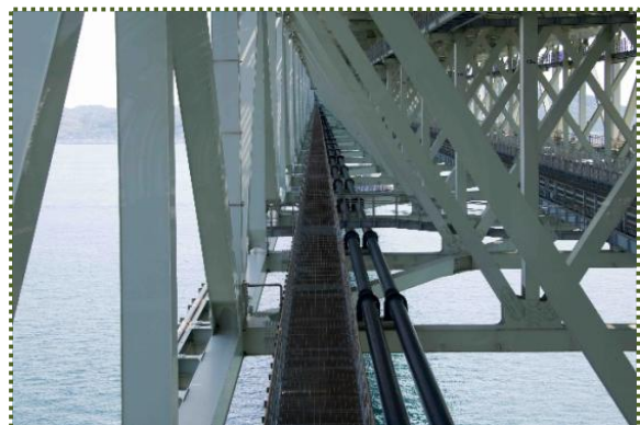
写真-8 明石海峡大橋に添架された 2 条の送水管
