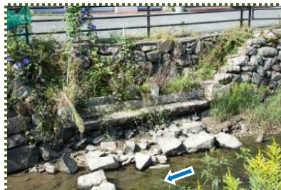
写真-6 加里屋川の崩れかけた雁木
