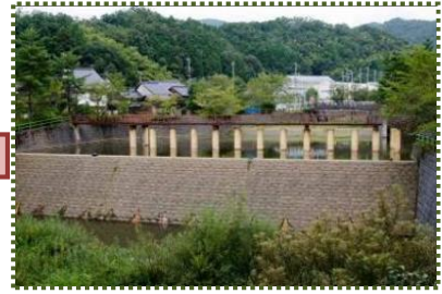
写真-17 放水路呑口上流の流木止め
