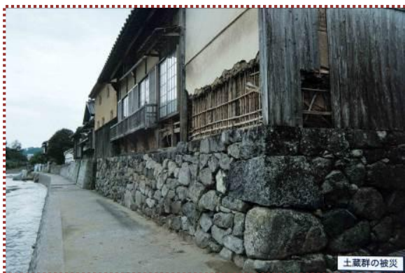
写真-8 土蔵群の被災状況 (平成 21 年 8 月)
