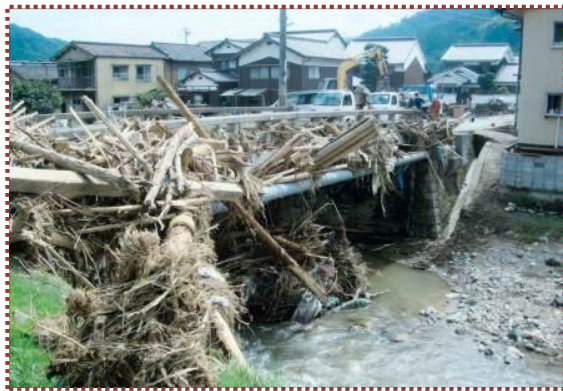
写真-6 流木が引っかった宮橋 (平成 21 年 8 月)
