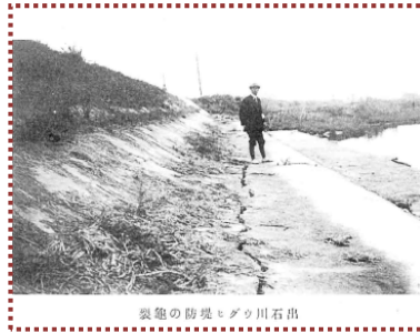
写真-5 出石川ウグイ堤防の亀裂
