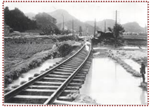
写真-2 昭和9年9月洪水による田君川の被災状況 (国鉄山陰本線・万ヶ崎信号所付近)
