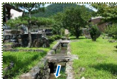
写真-3 光勝寺境内を横切る下水路
