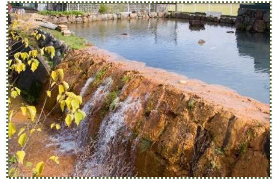
写真-4 池越流部および水路底の鉄さびの付着状況
