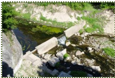
写真-11 川池末端部にある取水堰
