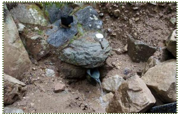
写真-8 災害復旧工事によりとりあえず水が汲める状態
