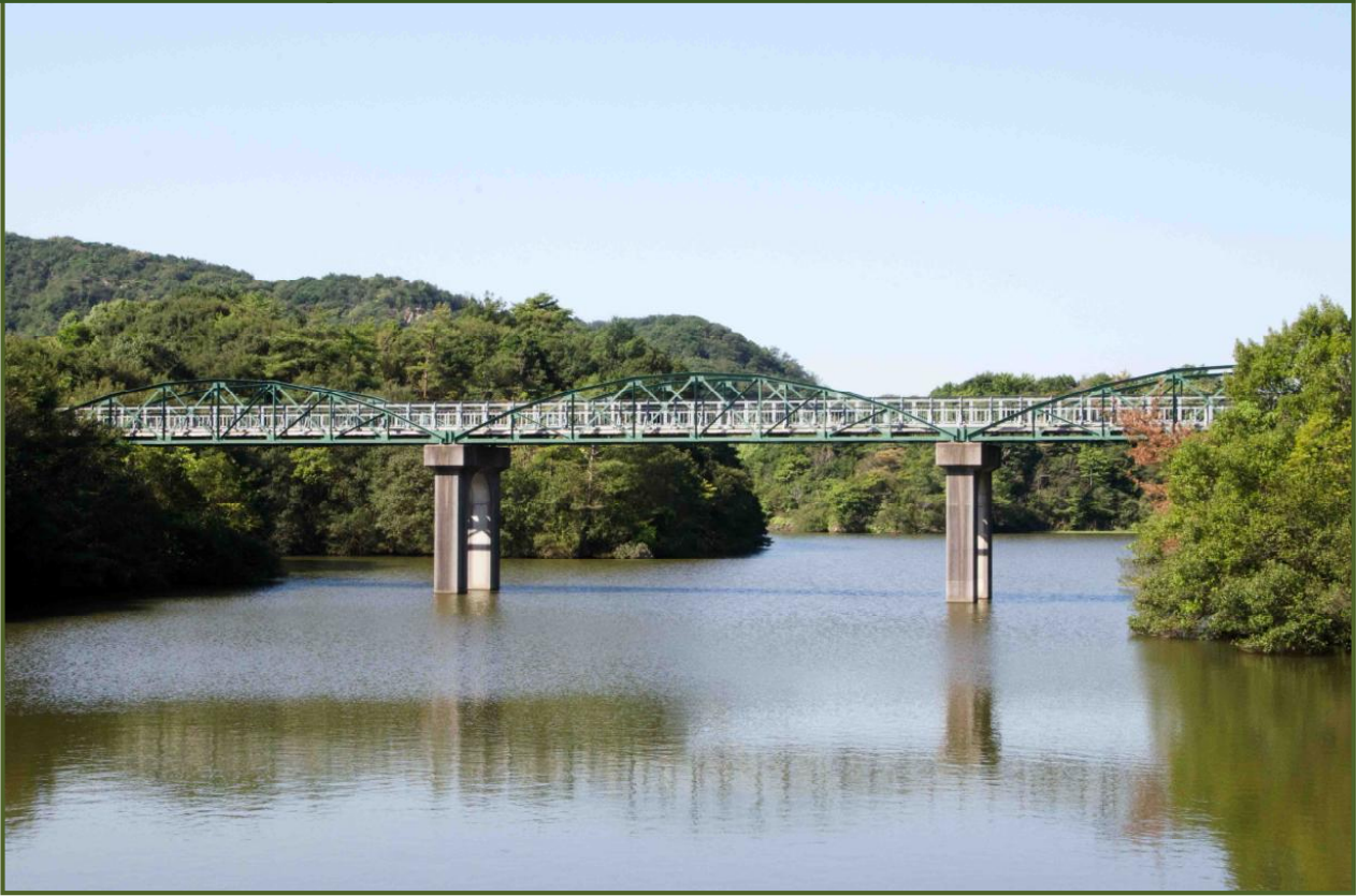
写真-1 県立淡路島公園・昭和池に架かる塩屋橋（平成25年9月）
