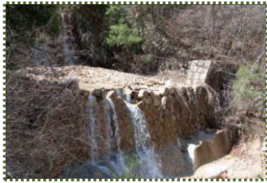
写真-12 崩れかけの 1 段目堰堤
