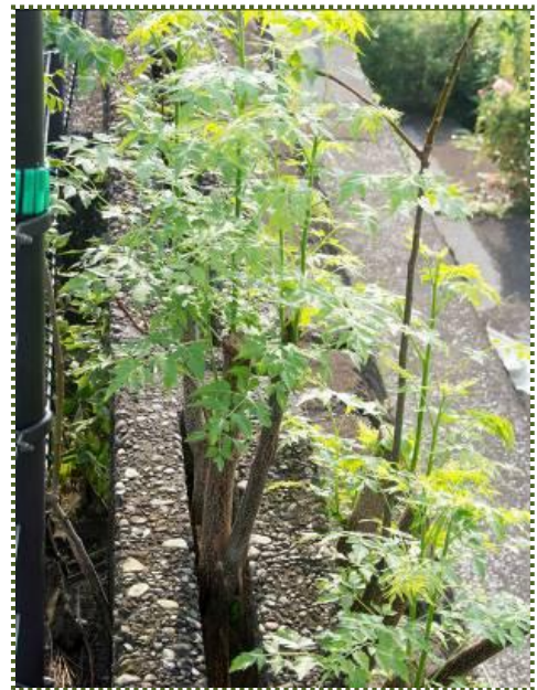
写真-15 畳堤の溝に根をおろしたセンダン
