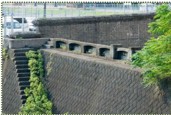
写真-13 板田橋左岸袂の窓が塞がれた畳堤
