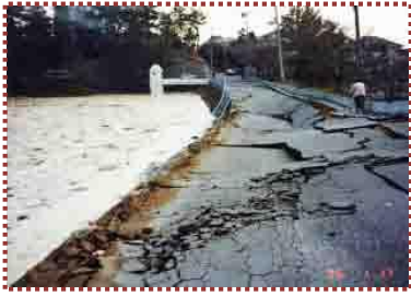
写真-13 ニテコ池 下堤の被災状況 (「阪神・淡路大震災 25 年事業 西宮市歴史資料写真展」から引用)
