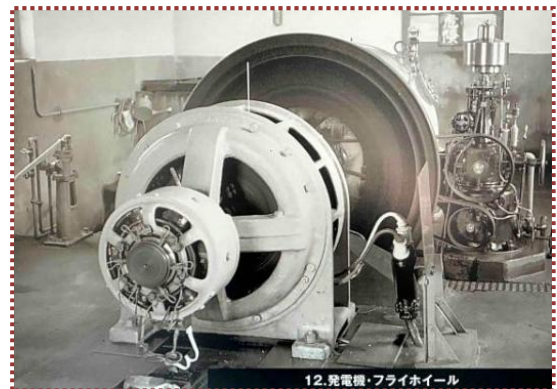
写真-12 発電機とフライホイール
