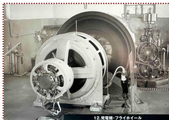
写真-12 発電機とフライホイール
