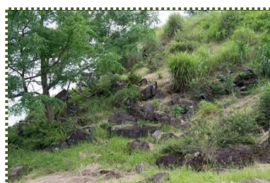
写真-10 崩落した天守台下部の石積
