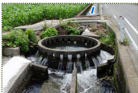
写真-13 円筒分水工
