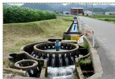
写真-14 円筒分水工
